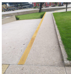
Figura 08 Desnível não sinalizado dos canteiros rebaixados Foto dos autores
